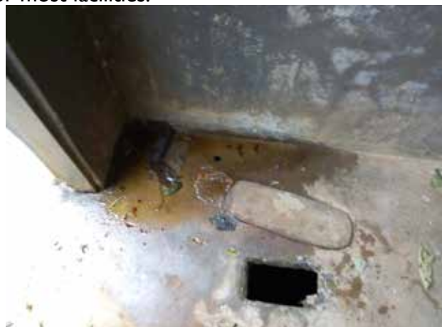
Dirty toilets at Ngarama HCIII
